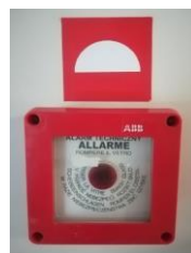
5.attēls. Elektroaizbīdņu distances vadības poga
